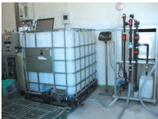
高品質尿素水製造プラント
