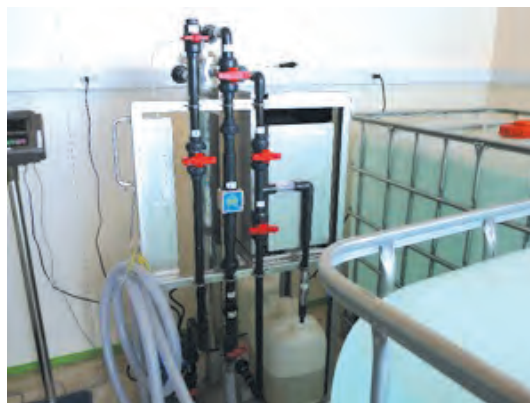
高品質尿素水製造プラント
